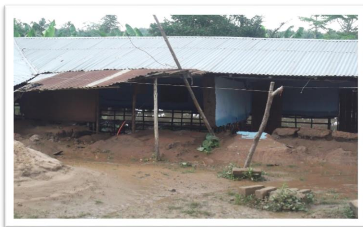
Photo 1: Destruction des hagdars par l'inondation
